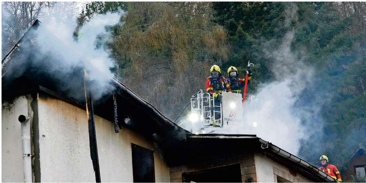
Am Vormittag kämpften die Feuerwehrleute immer noch gegen Glutnester im eingebrochenen Dachstuhl.
